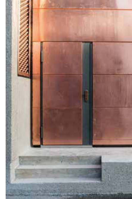
Zugang zu einer der Trafokammern Entrance to one of the transformer chambers
